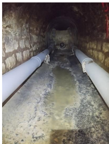
Ouvrage amont de mise à sec du réseau avec ouvrage interne de transfert
