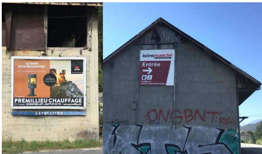
Publicités/préenseignes non conformes (mur non aveugle à gauche et dépassement des limites de l'égout du toit à droite)
