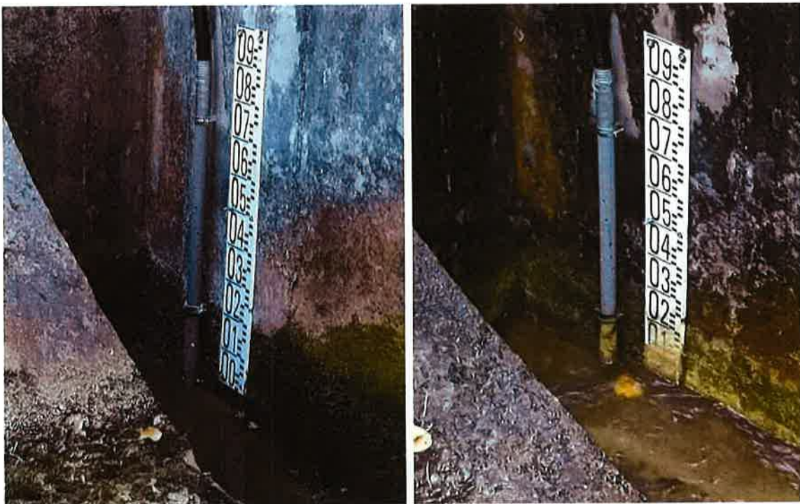
Figure 5 : Etat du dépôt calcaire après 15 mois de fonctionnement, entre le 12/07/22 (gauche) et le 20/10/23 (droite)
