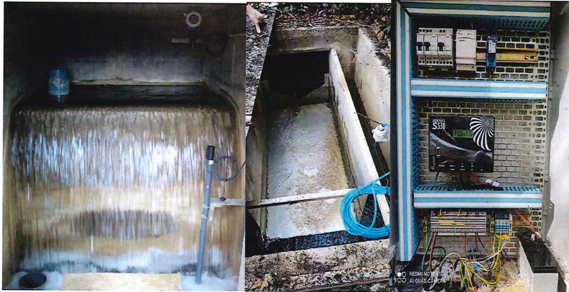
Chambre avale du captage avec la sonde de niveau par ultrason sur le seuil rectangulaire du bassin supérieur et la sonde de mesure de conductivité-température dans le bassin inférieur (à gauche), la sonde de niveau sur le trop-plein de la chambre amont (au centre) ainsi que le système de télégestion et le pluviomètre sur la chambre de distribution (à droite)
