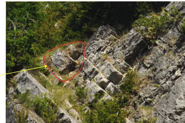
Fig. 22 : vue rapprochée de l'instabilité 11 (≈ 2 x 1 m 3 )
