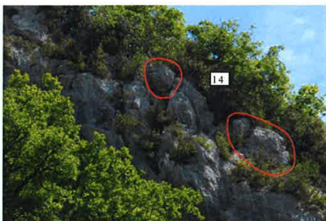
Fig. 10 : vue détaillée des instabilités 4 / barre C (≈ 2 m 3 )
