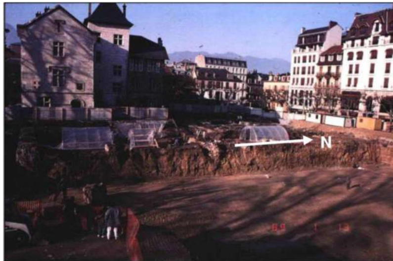
Photo 6 : Photos des travaux de terrassement du parking de l'Hôtel de Ville (SAS Savoie, annotées)
