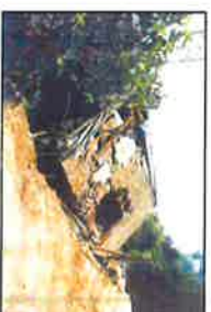
▼ Dommages au cellier de M.Perthoud en 1994 Photo BRGM 1994
