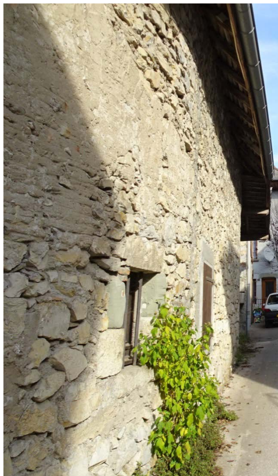
Si les pierres apparaissent c'est que l'enduit est usé.
