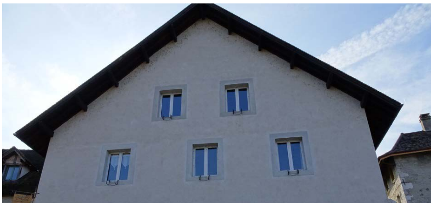
Perte des volets et des partitions du vitrage : appauvrissement de la façade
