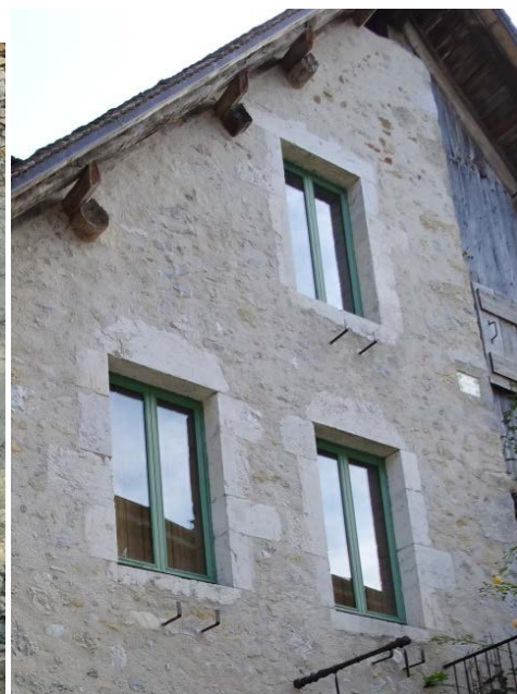
appauvrissement de la façade
