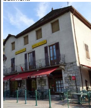
Enduit du rez-de-chaussée décroûté. Interdit.
